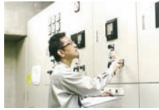
電気設備の点検と保守
